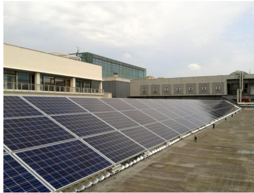
Figura 4 - Moduli fotovoltaici installati presso il Dipartimento di Economia
