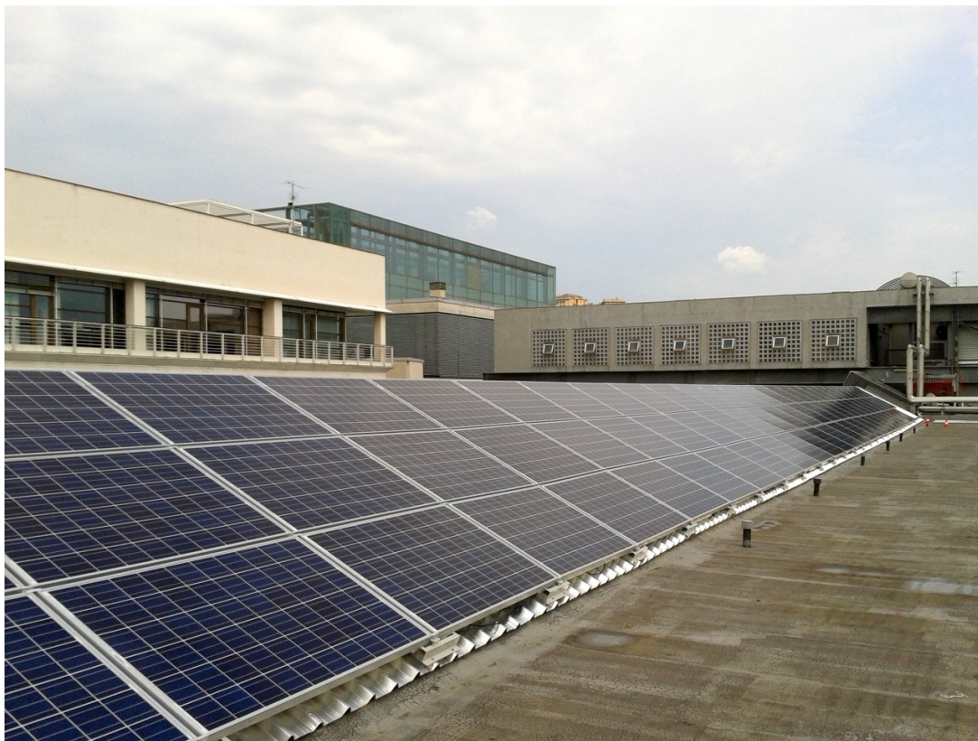
Figura 11 – moduli fotovoltaici installati presso il Dipartimento di Economia e Commercio in Darsena
