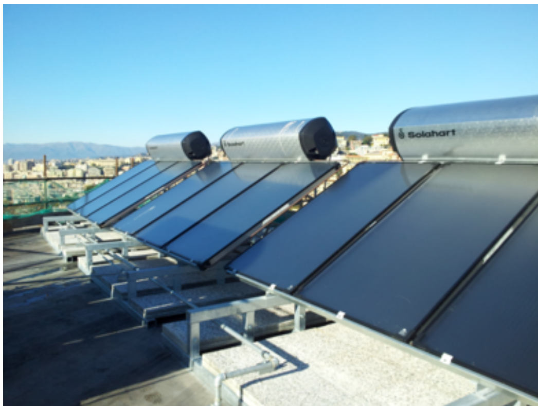
Figura 15 – dettaglio impianto solare termico di produzione di acqua calda sanitaria presso la clinica chirurgica
